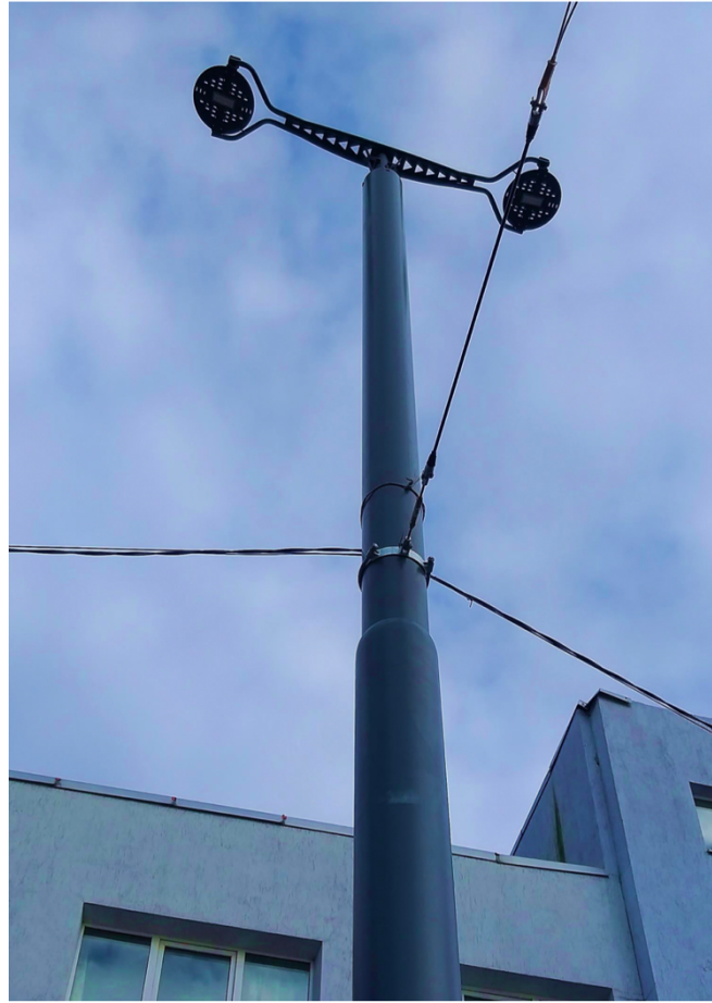
Рис 2.2. Опора контактної мережі виробництва «ELV» типу TSRK зі світильником
